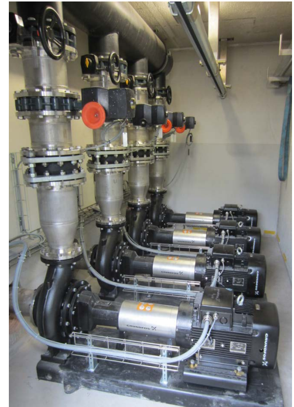
Pompes en // fraîchement rénovées (redimensionnées)
