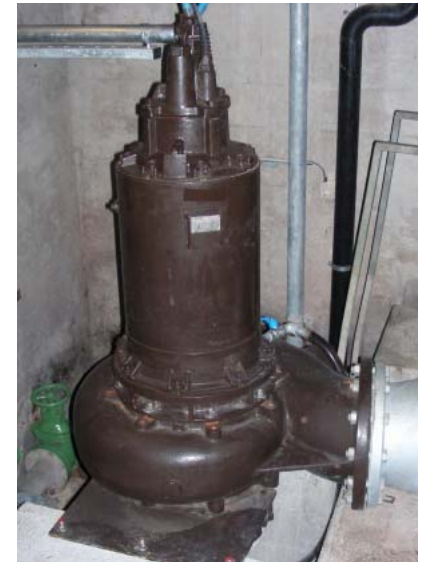
Pumpe Rohwasserzulauf (1 von 4)
